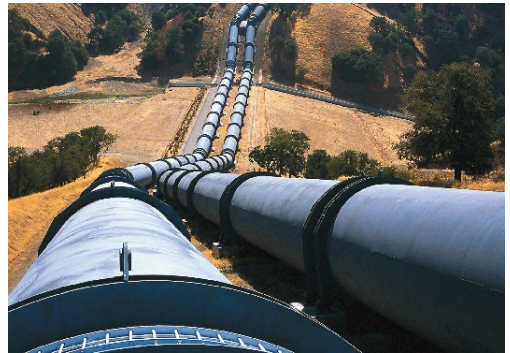
Одна з ділянок газопроводу Дашава—Київ
